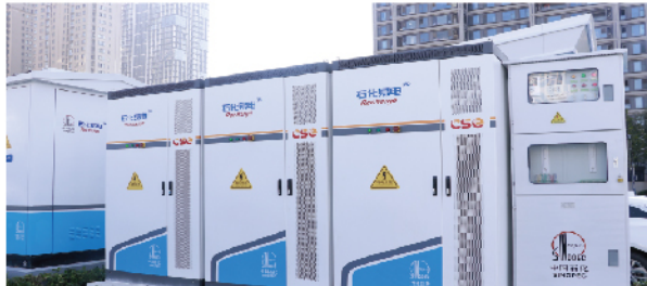
中石化合肥大众加油站光储一体项目
