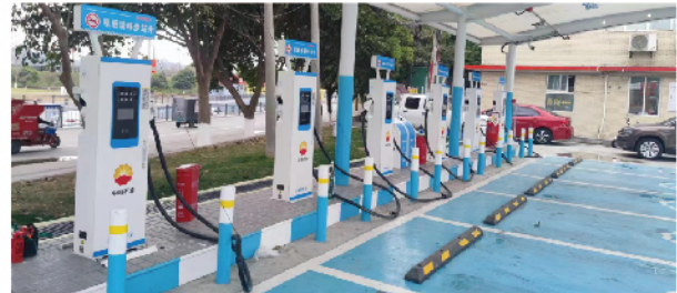
四川中石油充电站项目
