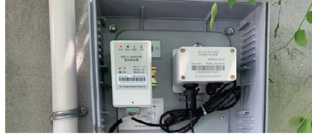
国网山东2023年第二次配网物资协议库存项目
